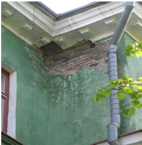
Рис.2. Разрушение штукатурного слоя наружной стены в месте замачивания атмосферными осадками из-за нарушения водоотвода с кровли
