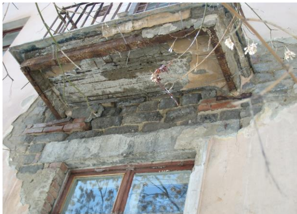
Рис. 5. Разрушение защитного слоя бетона балконных плит с обнажением и коррозией арматуры
