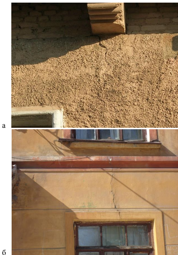
Рис. 4. Осадочные трещины в наружных стенах зданий с шириной раскрытия до 3 мм, длиной до 2,0 м
