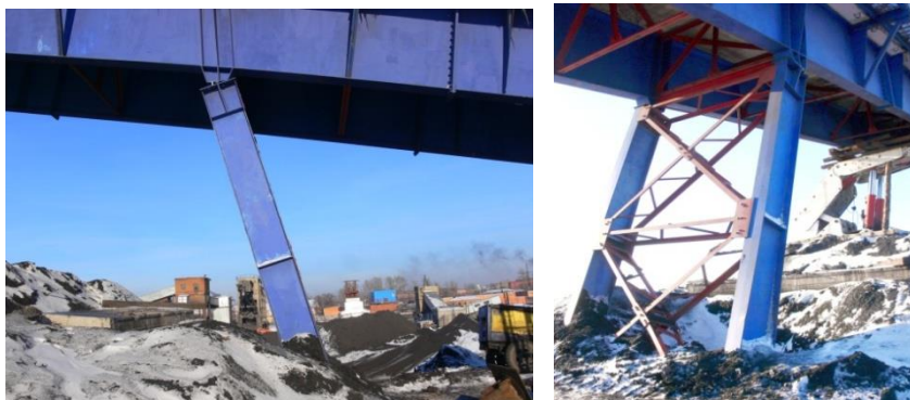
Рис. 2. Деформации металлической качающейся опоры по оси «К»
