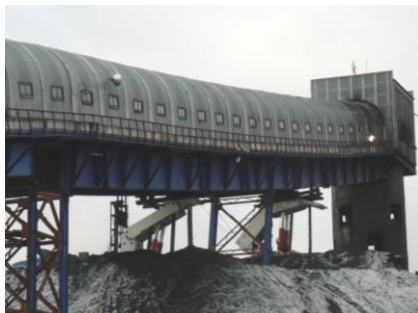
Рис. 3. Прогиб металлических балок Б1
