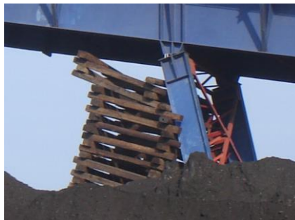
Рис. 4. Разрушенная ряжевая опора из деревянных брусьев
