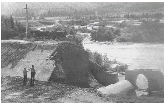
Рис. 10. Разрушение участка деривационного канала Земо-Авчальской ГЭС (Грузия)
