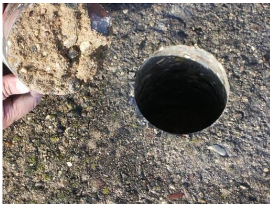
Рис. 12. Керн из монолитной бетонной плиты крепления грунтового откоса водохранилища. Состояние донной поверхности плиты – при бетонировании обратный фильтр вошёл в состав структуры плиты
