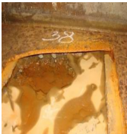
Рис.7. Отрыв листа металлической облицовки лотковой части секции горизонтального участка закрытой части водосброса. Фрагмент
