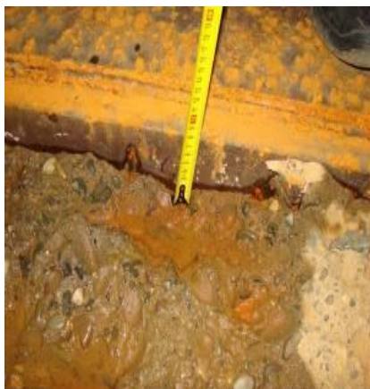
Рис. 8. Разрушение бетона под оторванным листом металлической облицовки секции участка закрытой части водосброса на глубину не менее 8 см
