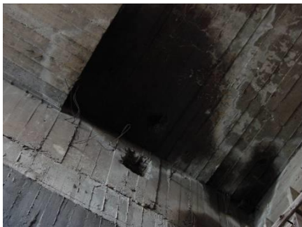
Рис. 5. Фильтрация масла через монолитный бетон массивного перекрытия (вид снизу)
