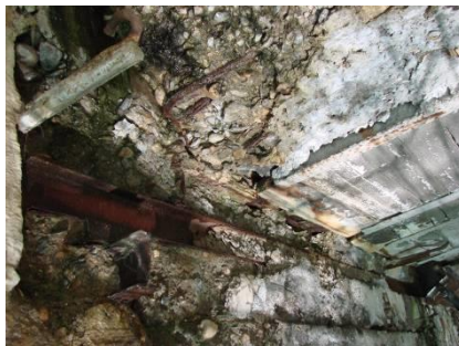
Рис. 2. Разрушения монолитного бетона в узле опоры балки на массивную стену из-за протечек по швам между блоками бетонирования
