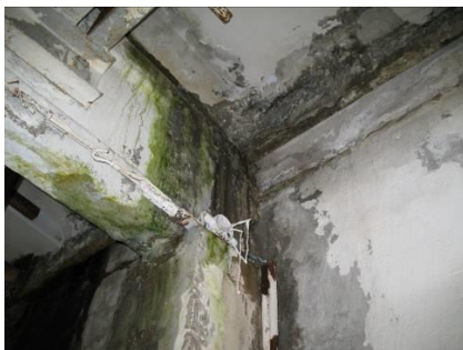
Рис. 3. Фильтрационное выщелачивание бетона в служебную галерею ГЭС в зоне дефектного шва между ярусами бетонирования
