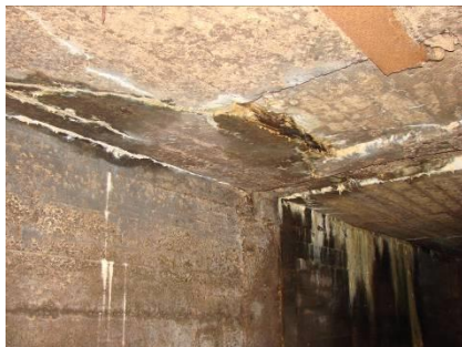
Рис. 1. Фильтрационное выщелачивание бетона в зоне дефектного шва между блоками бетонирования и через трещины в монолитном бетоне
